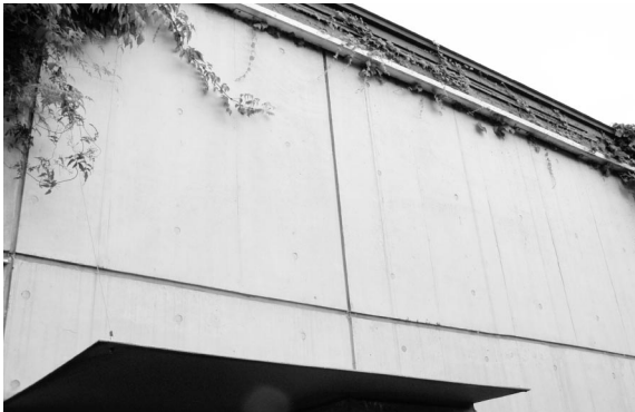
小さな水切りでも劣化防止効果は大きいと植田氏は語る。また、塗装後16年経過した撥水材の性能も落ちていない。
