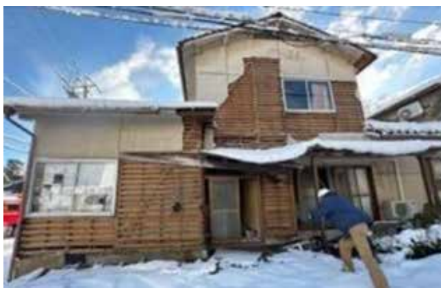
写真1 モルタル外壁の大規模な剥落
