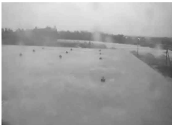
写真3 強風時には防水層が持ち上げられ、時に破損する。
